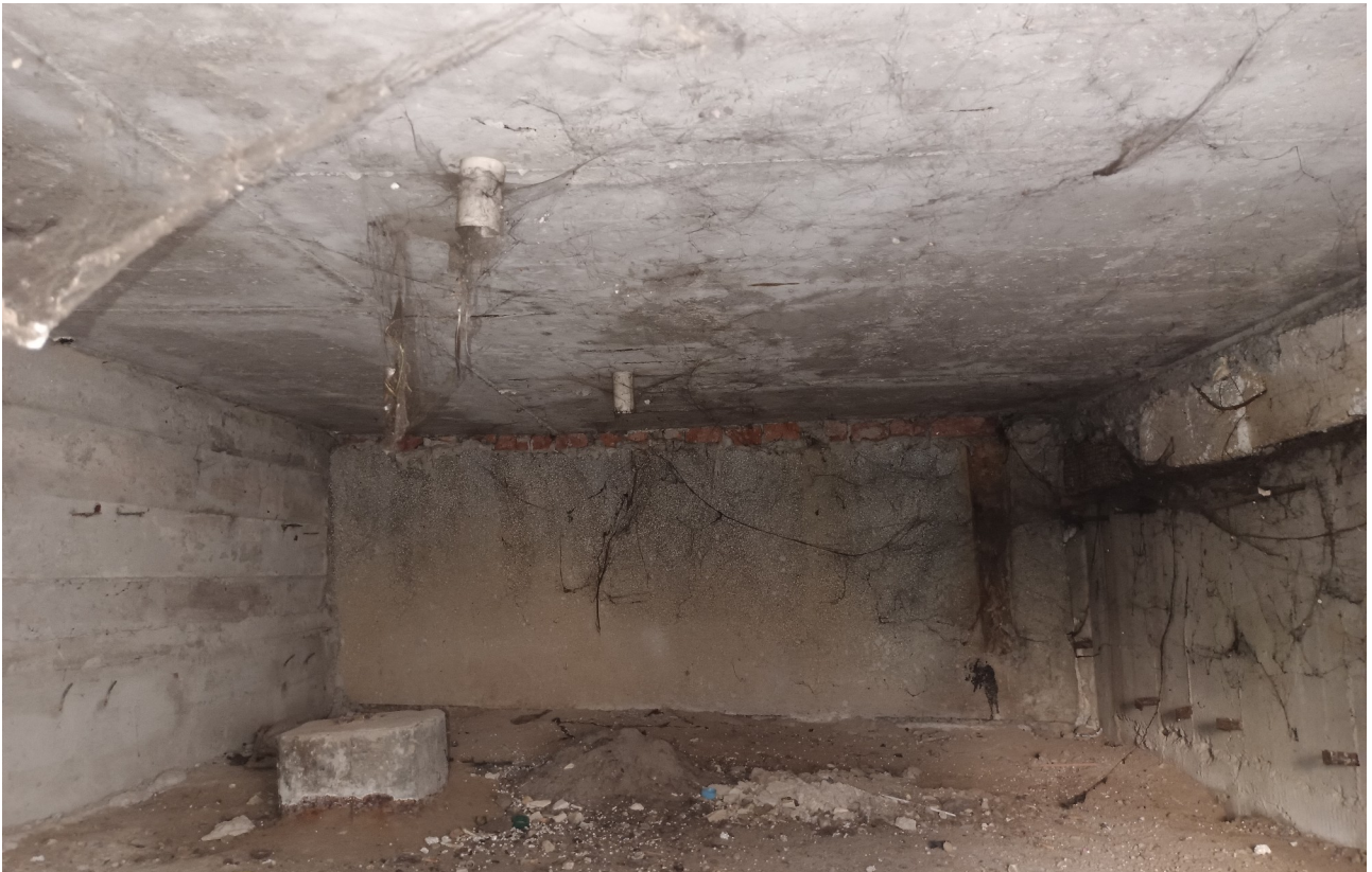
Fot 5. Widok przestrzeń pod schodami – brak rur odwodnienia.
