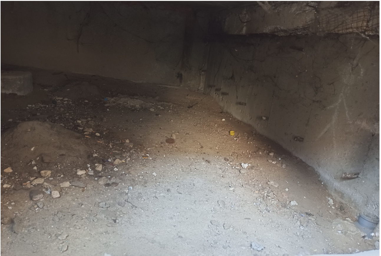
Fot 6. Widok przestrzeń pod schodami – rura odwodnienia do weryfikacji.
