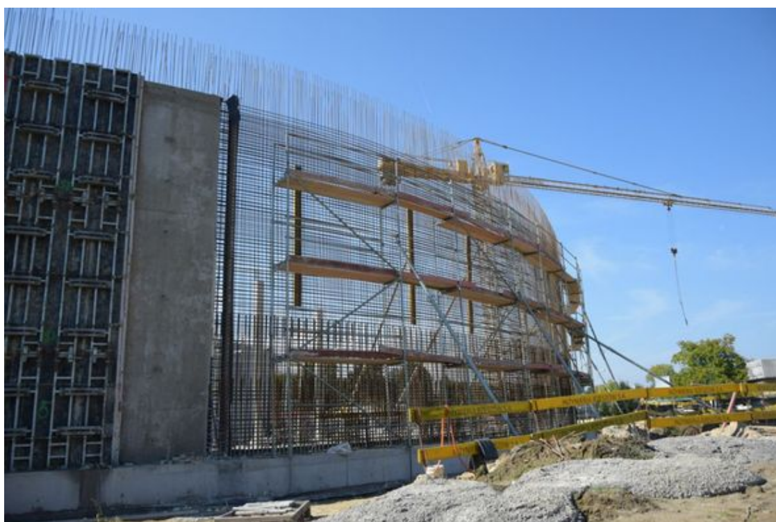
Zbiornik wody pitnej, fot. MPWiK Rzeszów
