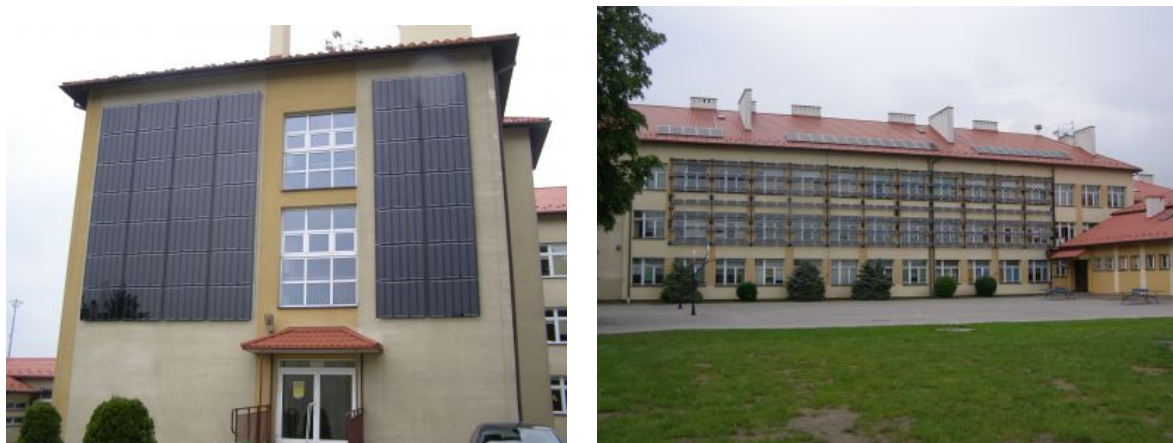
Fot.: Instalacje fotowoltaiczne zamontowane w Rzeszowie na budynku Szkoły Podstawowej nr 5 przy ulicy Słocińskiej
