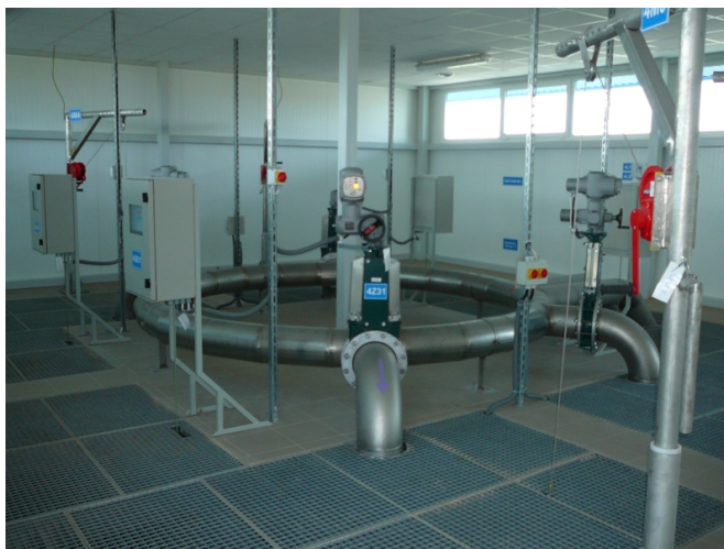
Stacja odwadniania osadów oraz wyposażenie - prasa Bellmera i instalacja technologiczna odstożników
